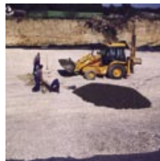
↑ Izolacija dna odlagališča, postavitve dražnih sistemov za zbiranje in odvajanje izcedne vode Isolation of landfill bottom, installation of drainage system for collection of leachate
